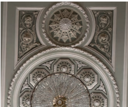
▲ Фрагменты потолочной лепнины комнат особняка
