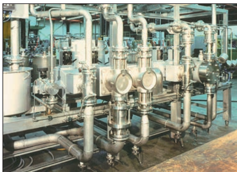
Рис. 1.2. Трубопроводы в химической установке
