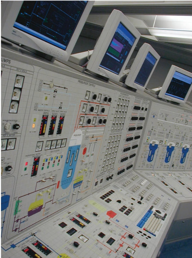
Рис. 1.1 ❖ Часть главного пульта управления водо-водяного реактора (PWR)
